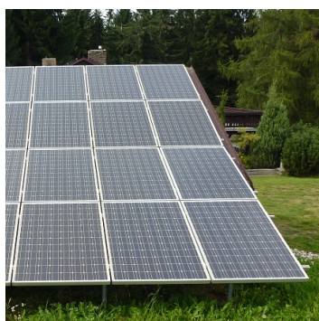
(a) FVE Střecha
