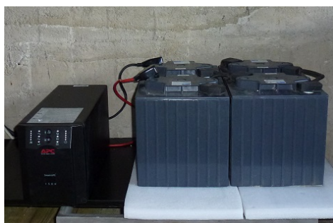
(a) Baterie + DC/ AC invertor
