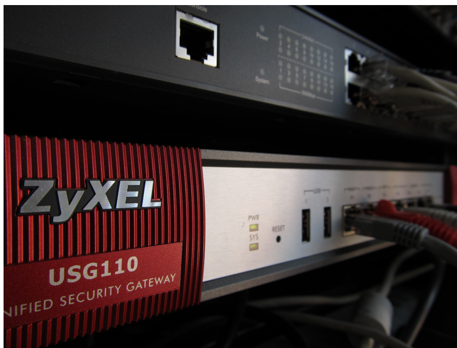
Obrázek 6.1: USG 110 umístěné v rackové skříni. Zdroj: vlastní zpracování, 2016
