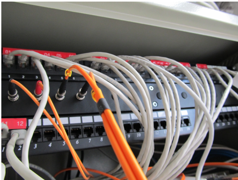
Obrázek 4.4: Optické kabely spojující hlavní budovu s přístavbou. Zdroj: vlastní zpracování, 2016
