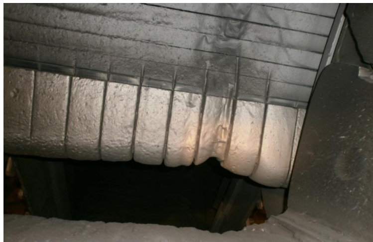
Obr. 2-10 – Rohové pancíře – cca 600 hodin [19]
