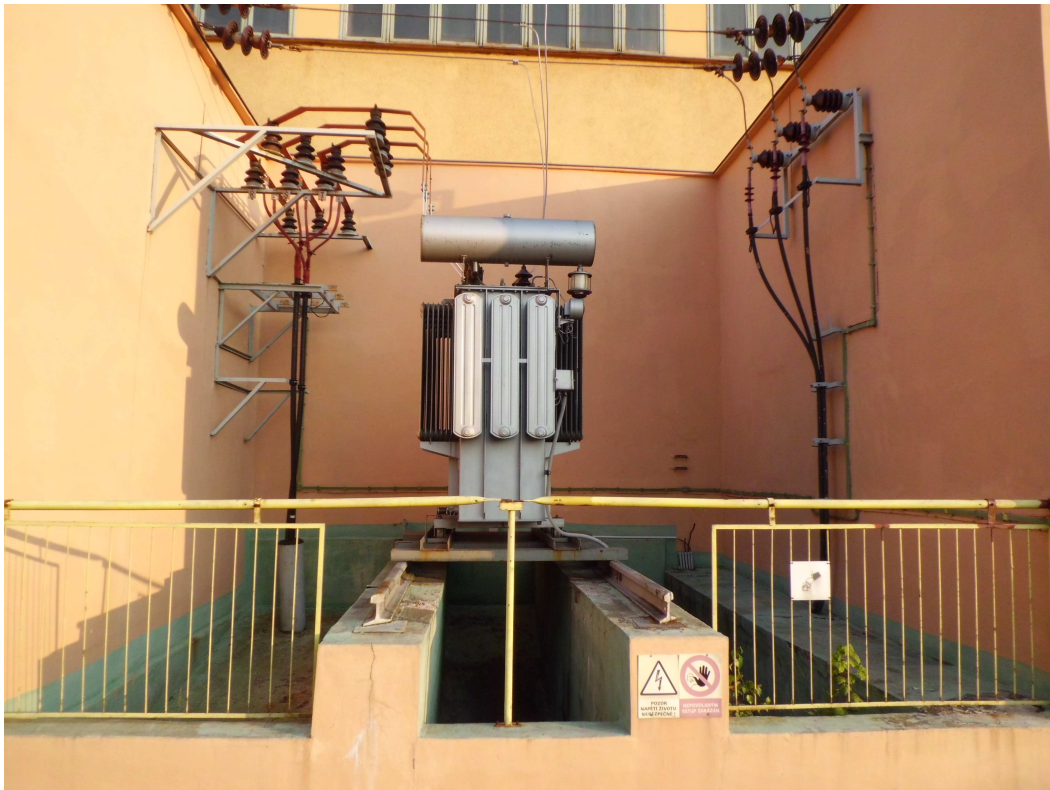
Obrázek 1.2 : Stanoviště blokového transformátoru 22/6,3 [kV] [26]
