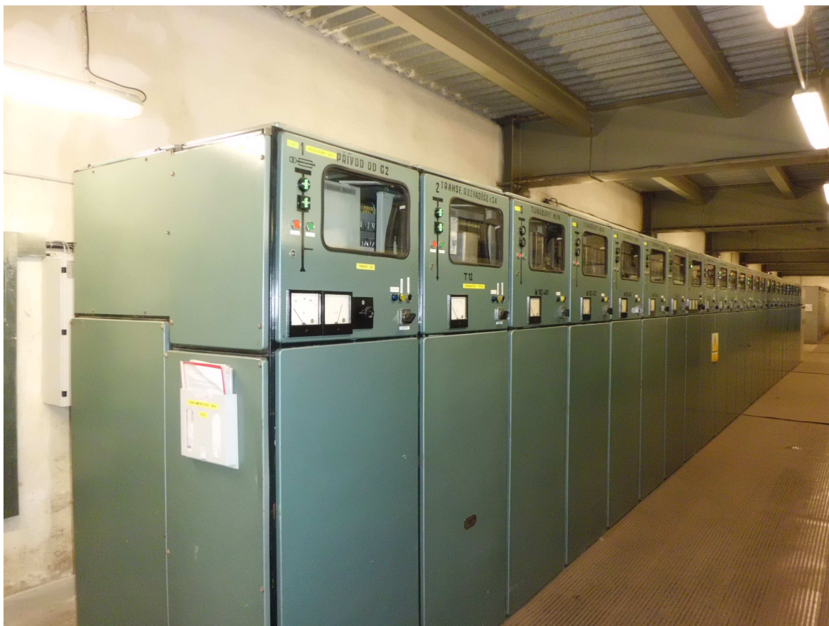
Obrázek 1.5 : Hlavní rozvodna 6 [kV] [26]
