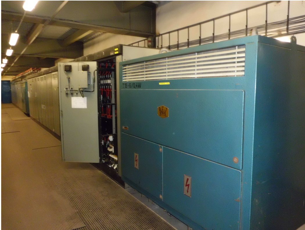
Obrázek 1.3 : Stanoviště transformátoru 6/0,4 [kV] -vlastní spotřeba [26]
