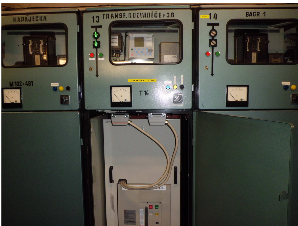
Obrázek 2.3 : Vypínač v modulovém rozváděči vn na ovládání blokového transformátoru [26]
