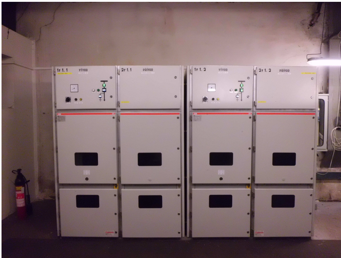
Obrázek 1.1 : Vstupní rozvodna 22 [kV] do průmyslového závodu [26]
