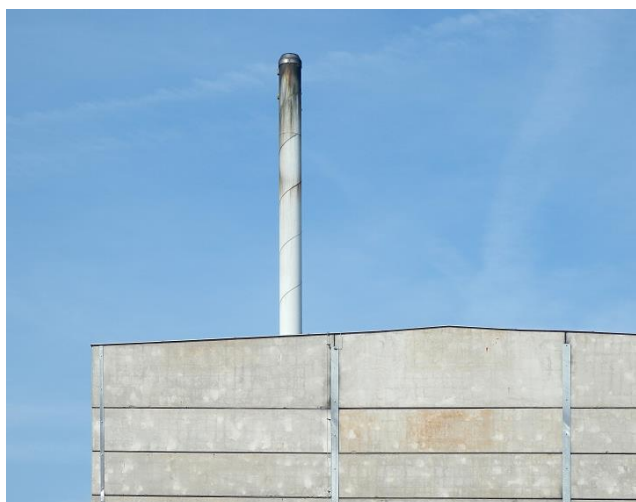
Obr. 2.16: Komín – horní venkovní část (zdroj vlastní).
