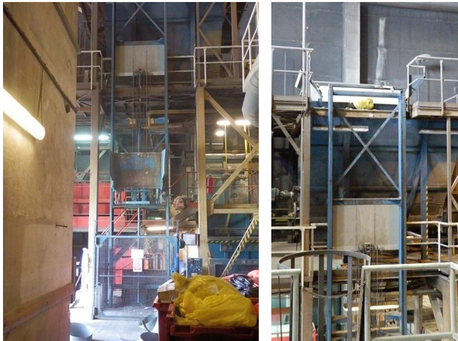
Obr. 2.4: Výtah pro kontejnery s odpadem (zdroj vlastní).
