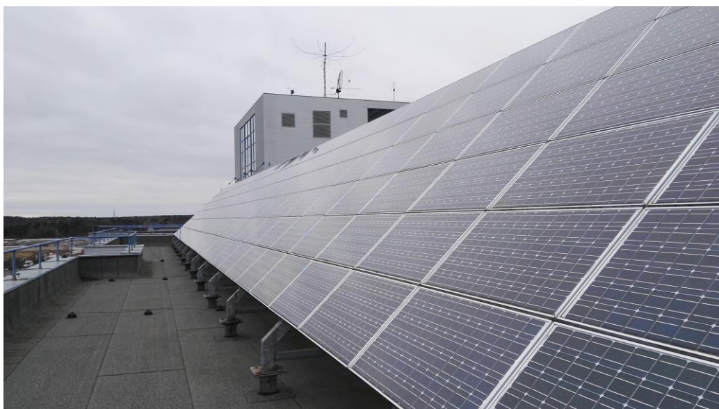
Obr. 1.2 Měřená FVE na střeše budovy Elektrotechnické fakulty v Plzni
