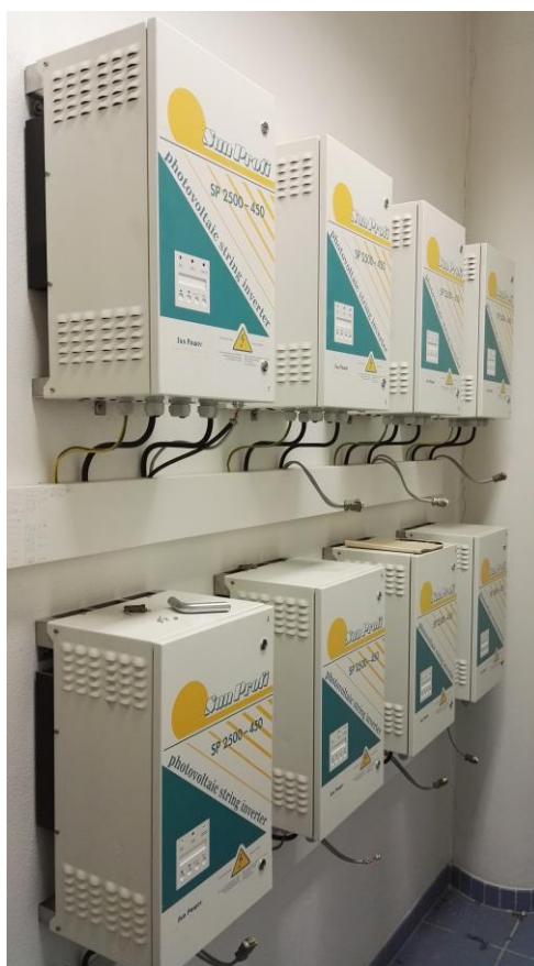
Obr. 1.6 Osm FV střídačů typu SP 2500 – 450 měřené FVE
