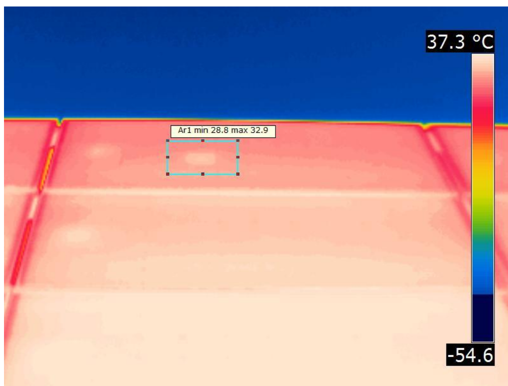
Obr. 3.11 Termograf z přední strany FV modulu číslo 96 s vadným FV článkem
