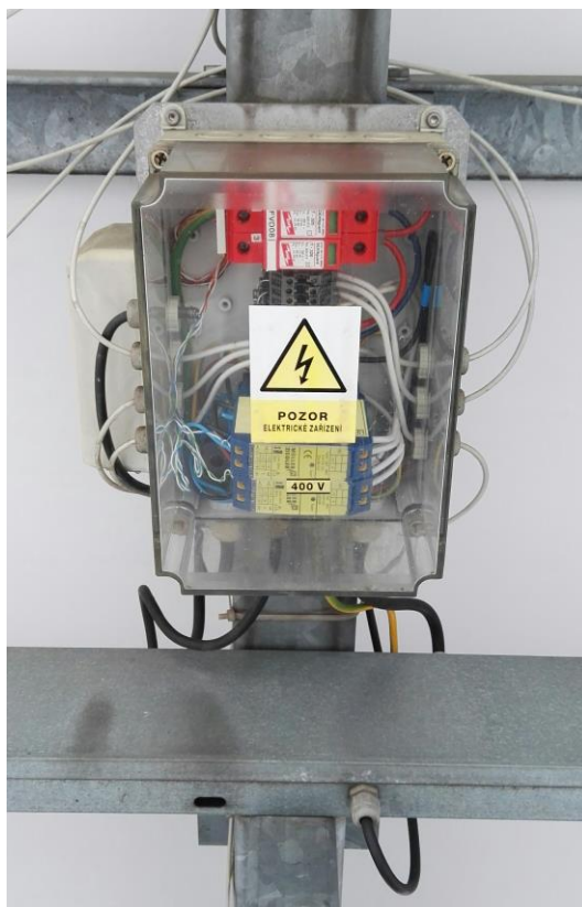
Obr. 1.7 Připojovací skříň měřeného FV generátoru
