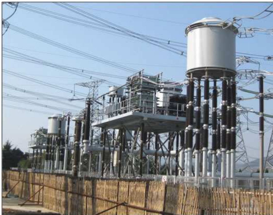
Obr. 40 Kondenzátorová stanice 500kV[18]
