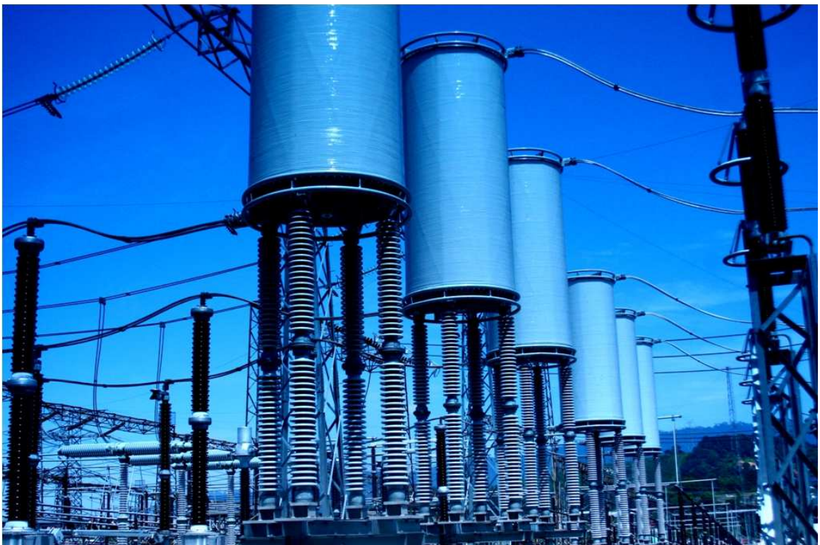
Obr. 41 Kondenzátorová stanice Kuala Lumpur[17]
