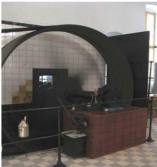
Obr.č. 29 Strojovna v elektrárně Písek - pohled na řemenici
