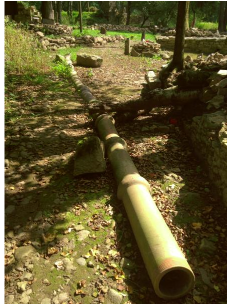
Bild Nr. 14 - Wasser- / Abwasserrohrleitung (Quelle: eigenes Foto)
