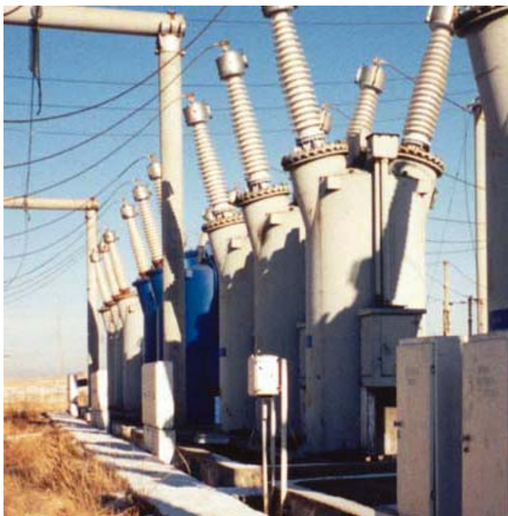
Obr. 1: Olejové kotlové vypínače 220 kV v rozvodně v Mongolsku; převzato z [4]
