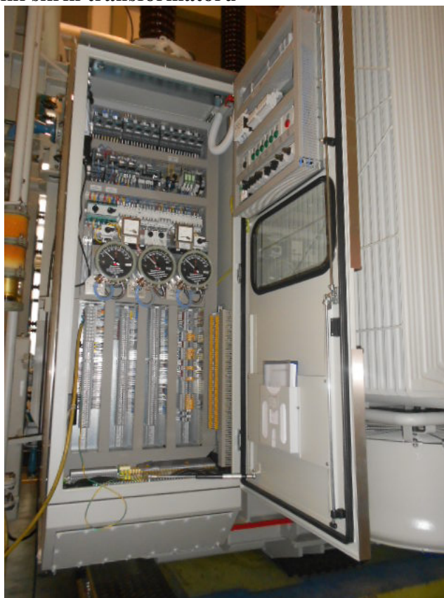
Obrázek 12 - Ovládací skříň transformátoru
