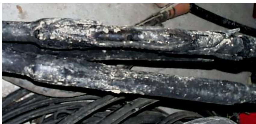
Obr. 28 Kabelová porucha na spojce XLPE (zde je zřetelné poškození sousedních fází)
