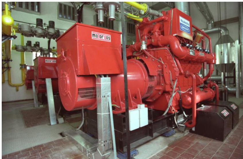
Obr. 7 – KJ s plynovým motorem Waukesha spalující bioplyn na ČOV Plzeň [36]
