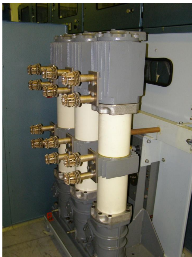
Příloha 10: Maloolejový vypínač HG 6kV
