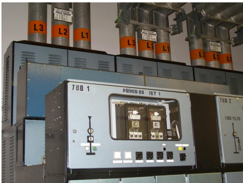
Příloha 6: Rezervní rozvodna 6 kV 7BB
