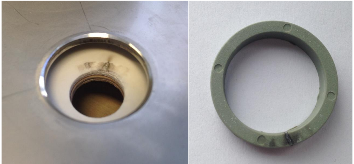
Obr. 3.25 Poškozené části průchodkové sestavy na pozici 8 - zleva izolant durapol, opěrný kroužek
