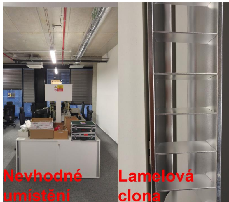
Obr. 3.20 Nevhodné umístění osvětlení a vyměněná lamelová clona
