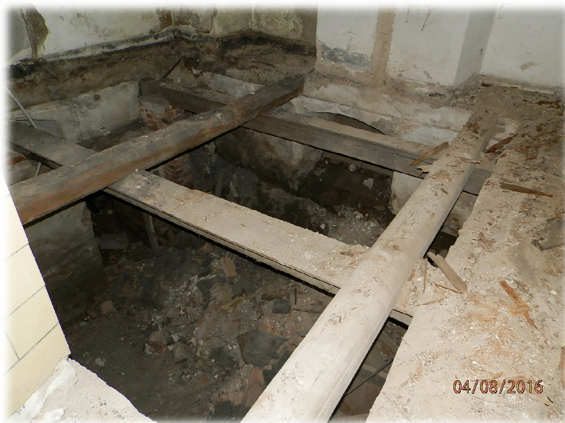
Obr. 1.6 Propadlý dřevěný trámový strop 1.NP zámku
