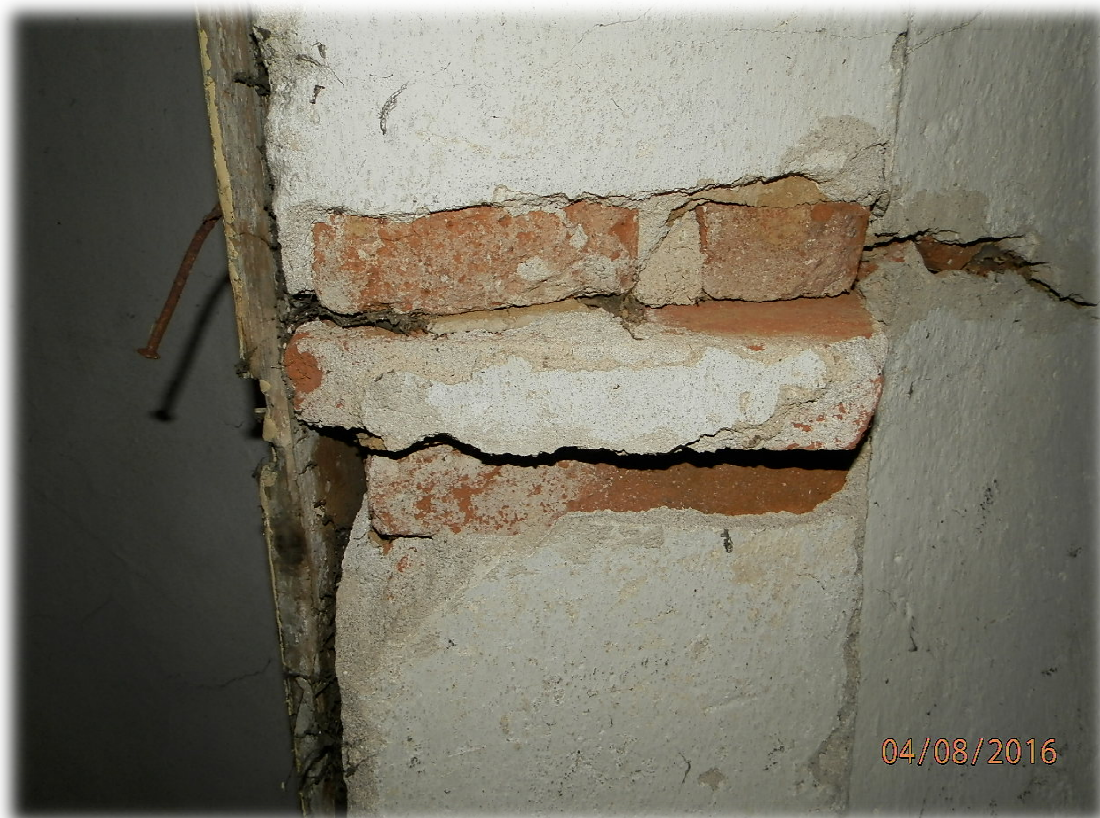
Obr. 1.9 Uvolněný překlad u vstupu na schodiště do půdních prostor
