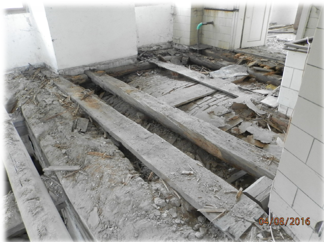
Obr. 1.7 Rozpadlá konstrukce stropu nad klenbou
