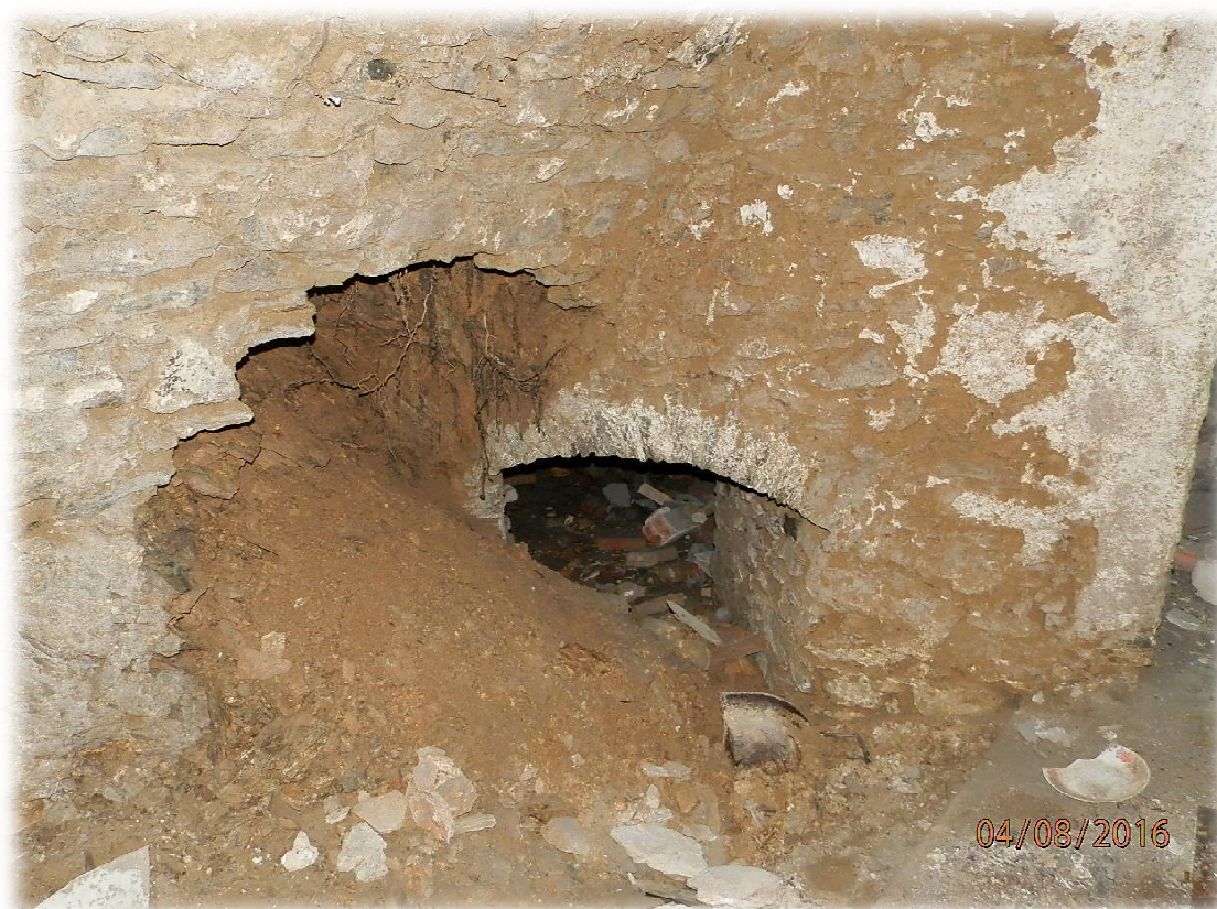
Obr. 1.2 Rozpadlá část stěny ve sklepních prostorách
