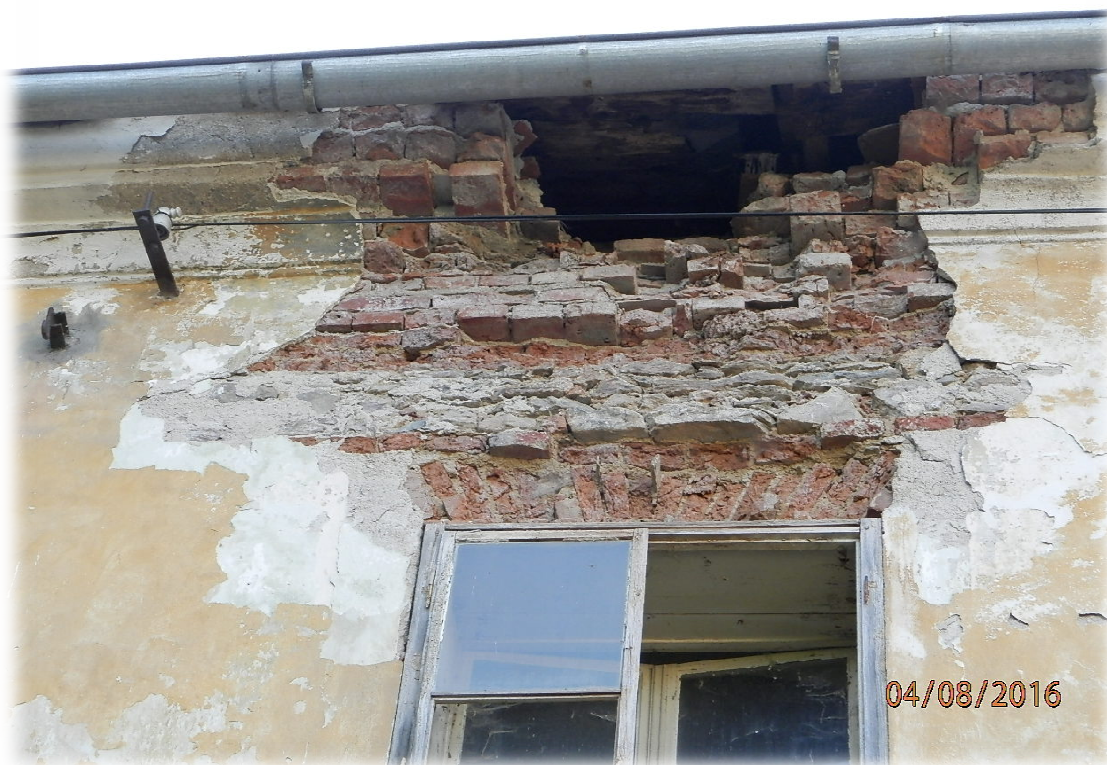
Obr. 1.1 Rozpadlá část zděné římsy ve východním průčelí zámku
