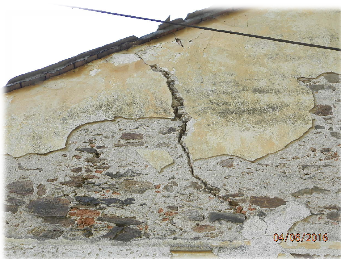
Obr. 1.3 Trhlina obvodového zdiva v jižním průčelí zámku
