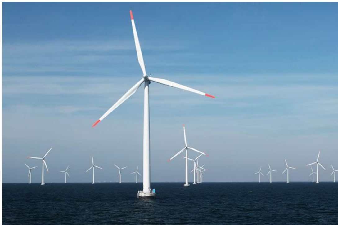
Obr. 4.11 Mořský větrný park London Array
