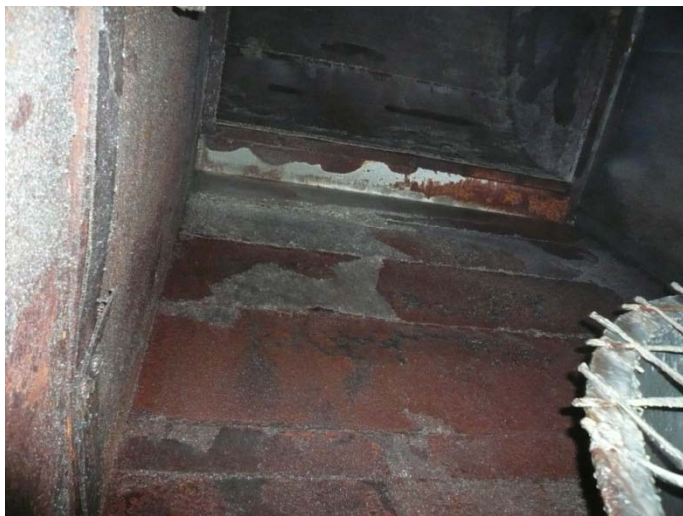
Obr. č. 3 Kabina rekuperace linky zevnitř – současný stav
