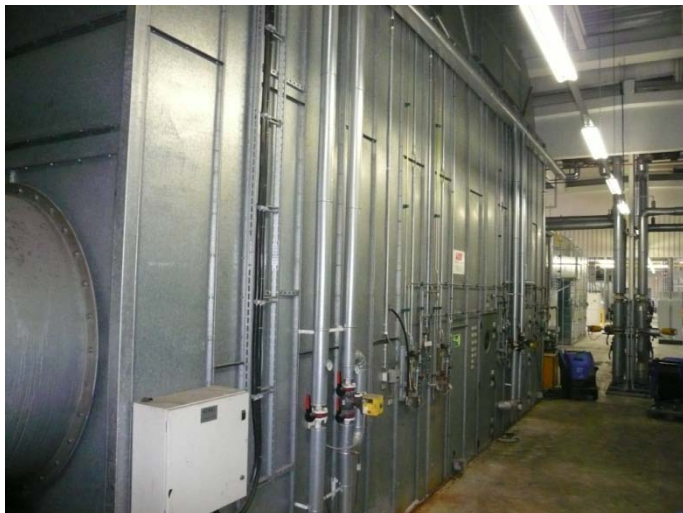
Obr. č. 2 Kabina rekuperace linky zvnějšku – současný stav
