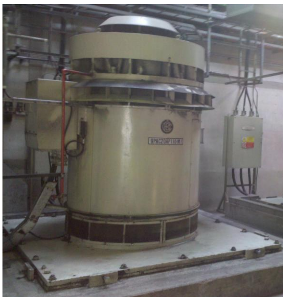
Obr. 2.2.1: Motor chladicího čerpadla
