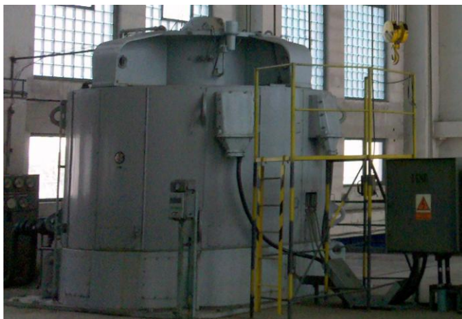
Obr. 2.1.2: Motor chladicího čerpadla
