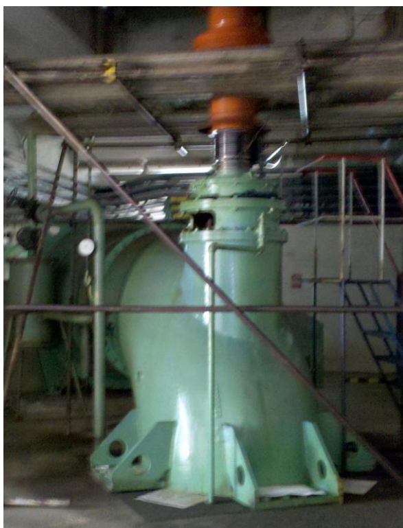
Obr. 2.1.3: Výtlak chladicího čerpadla
