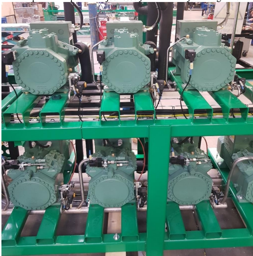
Obrázek 5-14: Detailní pohled na potrubí v jednotce
