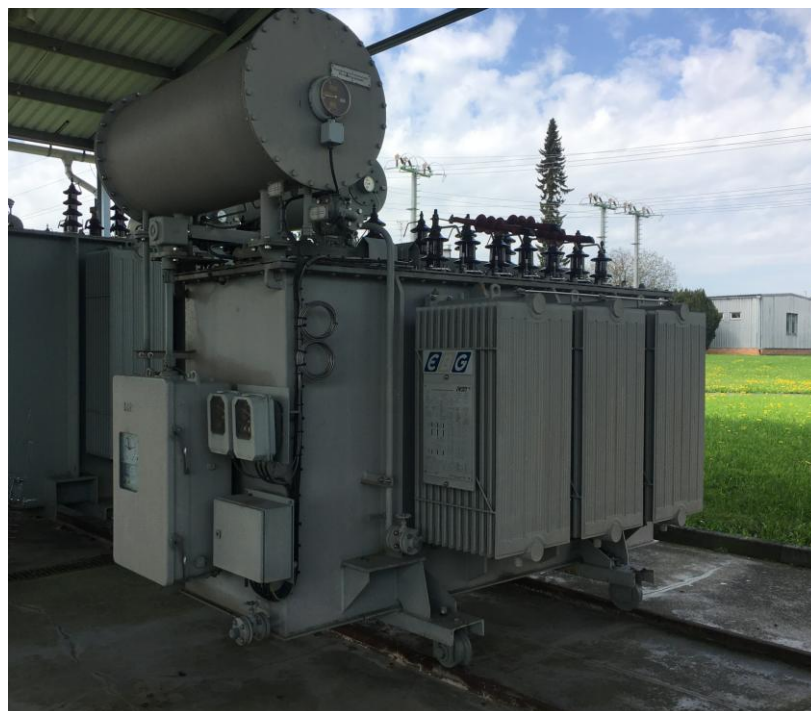
Obrázek č. 26: Transformátor EBG - DOR 4500/30
