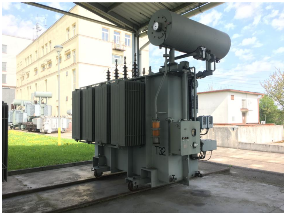
Obrázek č. 27: Transformátor ABB – DOHHR
