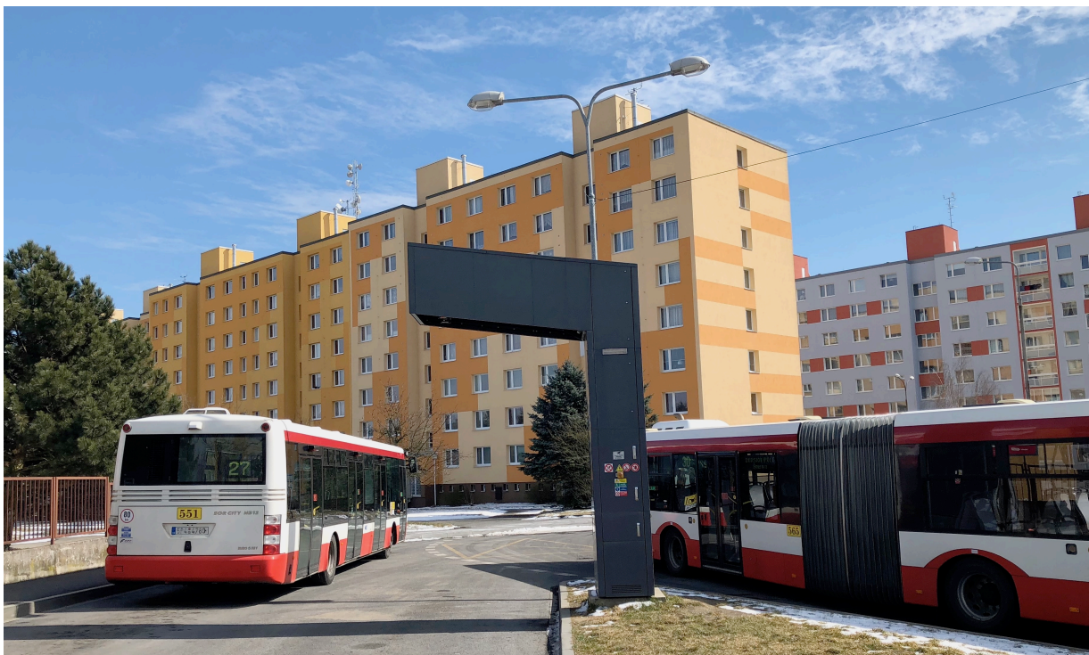
Obr. 1.3 Automatizované nabíjecí rameno na konečné zastávce Košutka v Plzni
