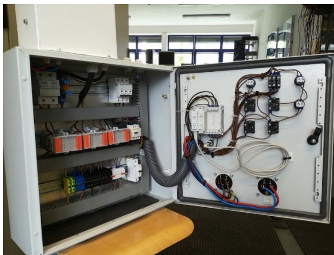
Obr. 26.: Zkompletovaný vnitřek rozvaděče
