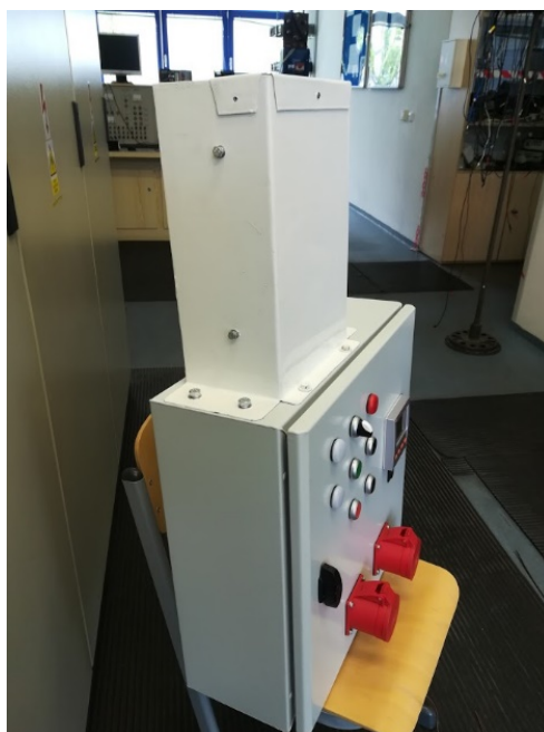
Obr. 27.: Zkompletovaný vnějšek rozvaděče
