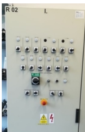
Obr. 1.: Rozvaděč R02 I.
