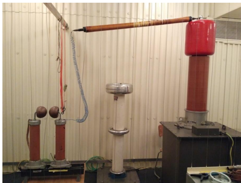
Obr. 2.2 Zapojení měření – transformátor (vpravo) a kulové jiskřiště (vlevo)
