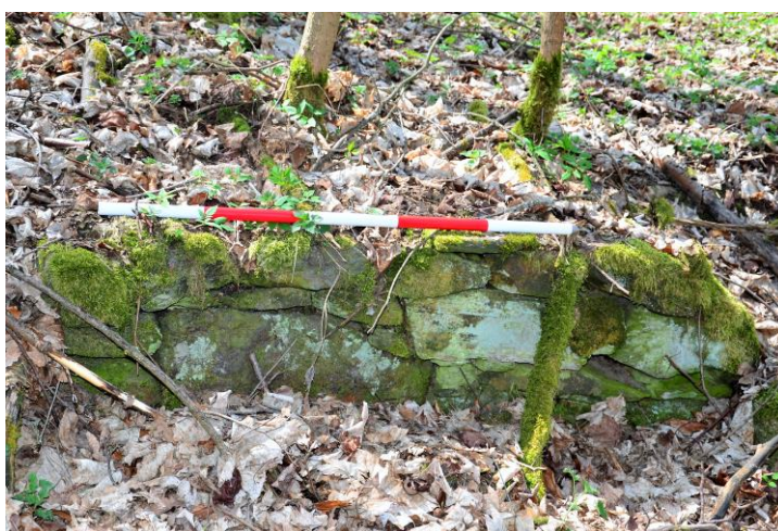
Obrázek 40: Pozůstatek zdiva na parcele č. 36. Pohled od východu. 14. 4. 2018.
