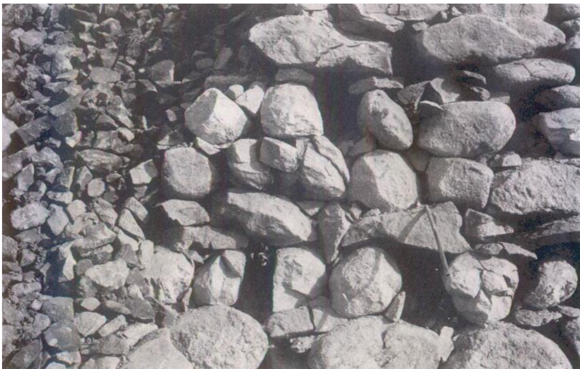
Obr. 45: Aberdeen. Detail zdi jihozápadní stěny, jejíž úsek se zhroutil (Ralston 1986, 31).
