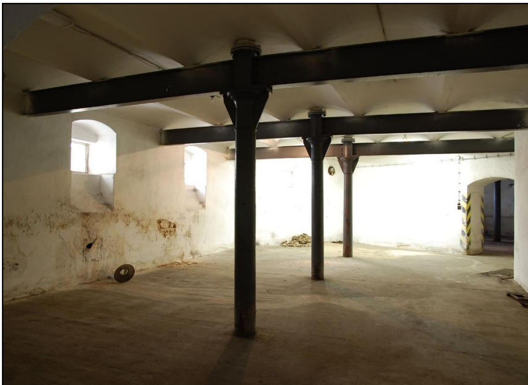
Příloha č. 26 – Interiér pivovaru před rekonstrukcí v roce 2008. Zdroj: Národní technické muzeum, Centrum stavitelského dědictví Plasy.
