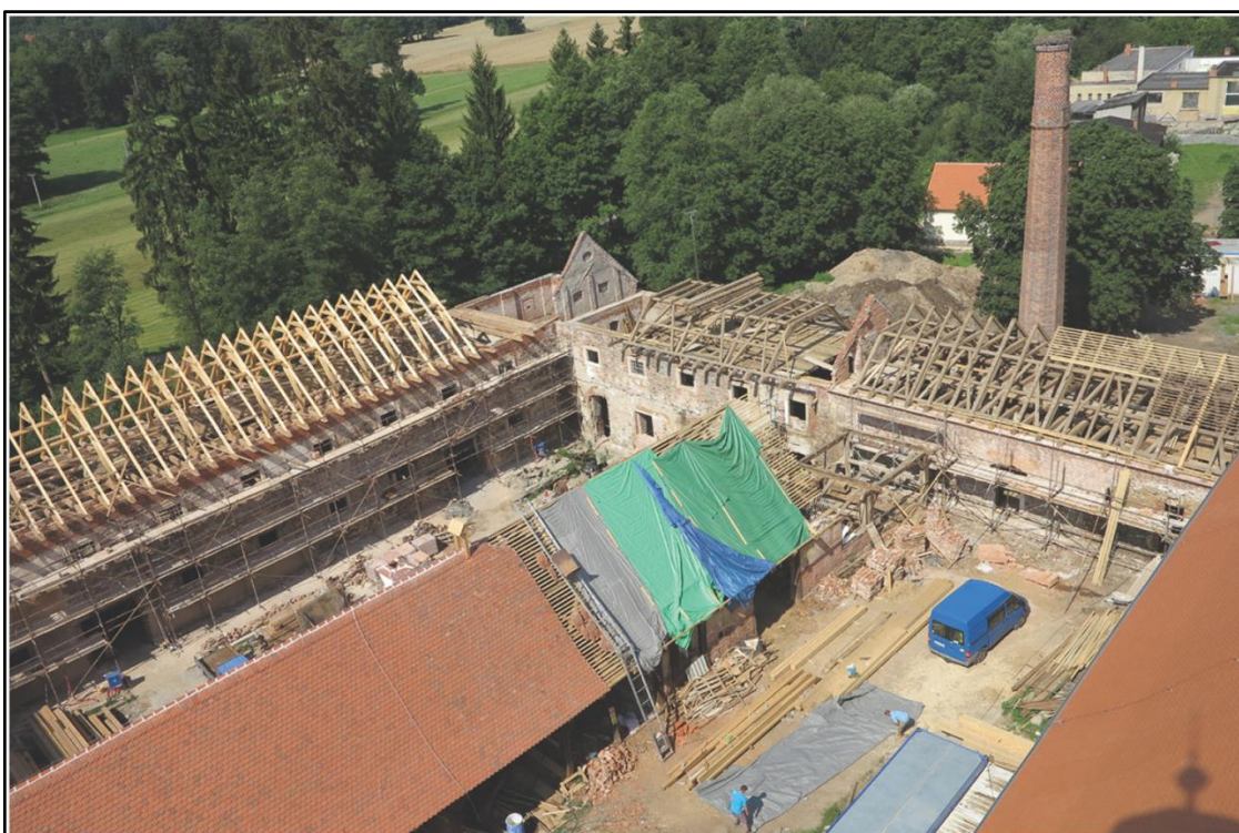
Příloha č. 59 – Hospodářský dvůr během obnovy v roce 2014. Zdroj: Národní technické muzeum, Centrum stavitelského dědictví Plasy.
