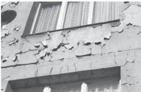
Obrázek 30 - Nepravidelné trhliny na vnějším povrchu [3]
