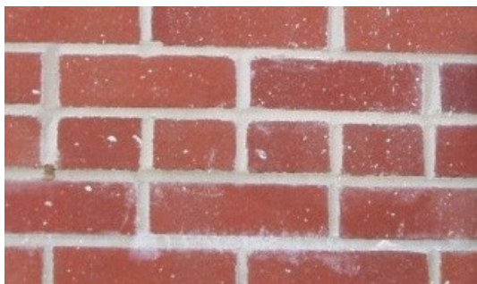
Obr. 4.3. Nedostatečná vazba zdícího prvku
