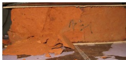
Obr. 4.8. Tlakové porušení cihly [33]
