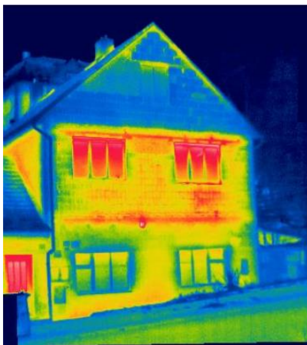
Obrázek 25 Tepelné mosty rodinného domu na termogramu
