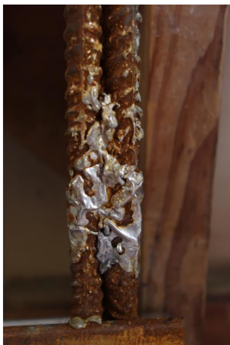
Segment I - cín aplikovaný na očištěném a ošetřeném povrchu modrou skalicí technikou letování i odlévání po měsíci působení venkovních vlivů. 16
