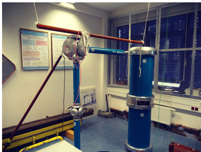
Obrázek P.2: Vysokonapěťový prostor laboratoře
