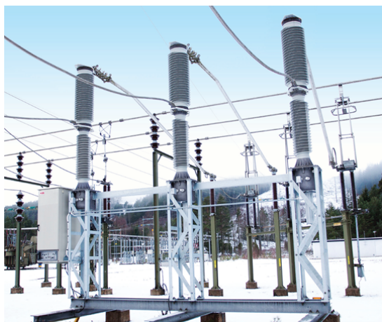
(a) Vypínač ABB LTA 145 kV
