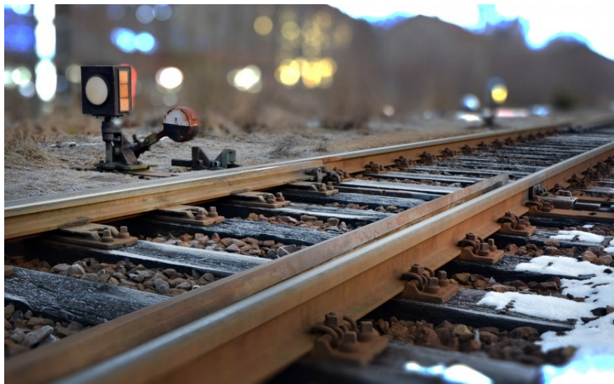
Obrázek 1.1.1 Příklad diagnostikovaného systému ŽDC – výhybka [3]
