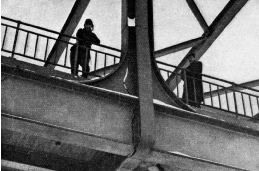
Obrázek 11 - Trhlina na mostě Harenthals - Oolen, 1940
