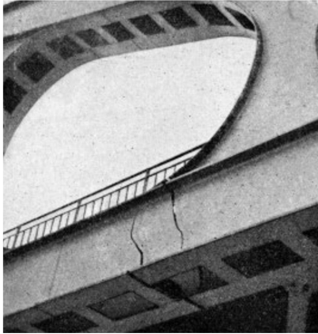
Obrázek 13 - Trhliny mostu Hermalle, 1940
