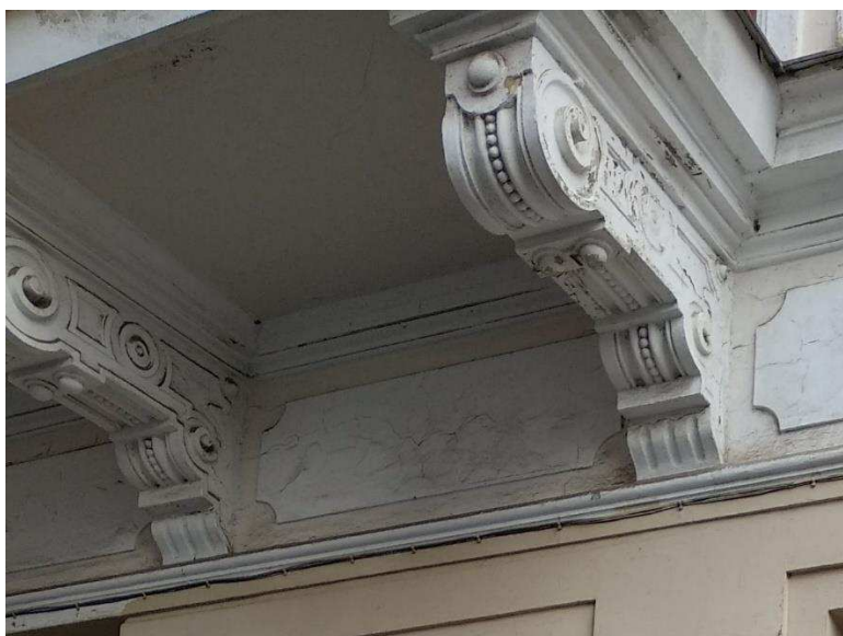
Obrázek 28 Nakaširovaná konzola balkónu objektu čp. 8
