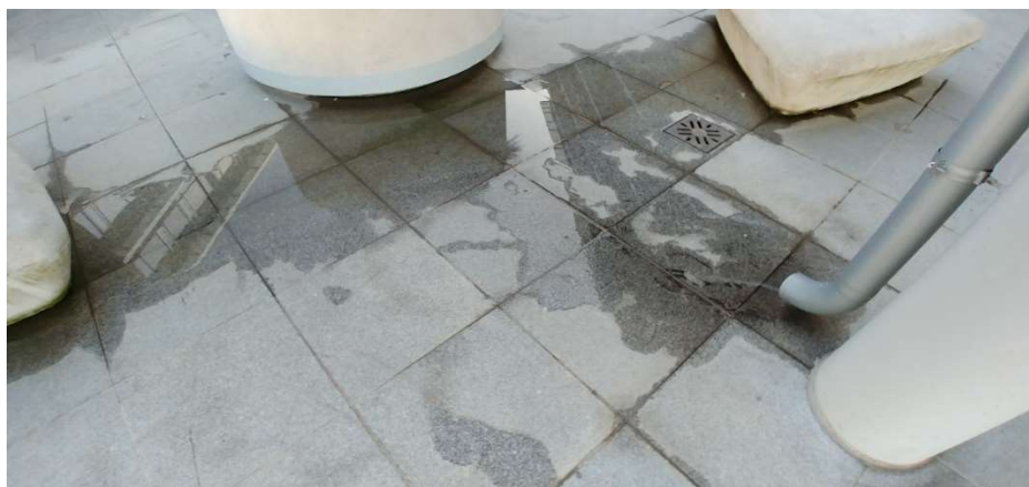
Obrázek 19: Fotografie špatného spádování dlažby vůči vpusti, Zdroj: Autor
