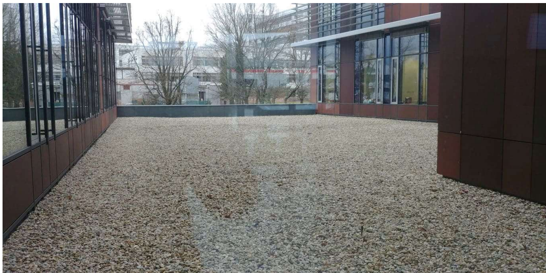
Obrázek 14: Fotografie střechy nad 1.PP pořízená z chodby 1.NP
