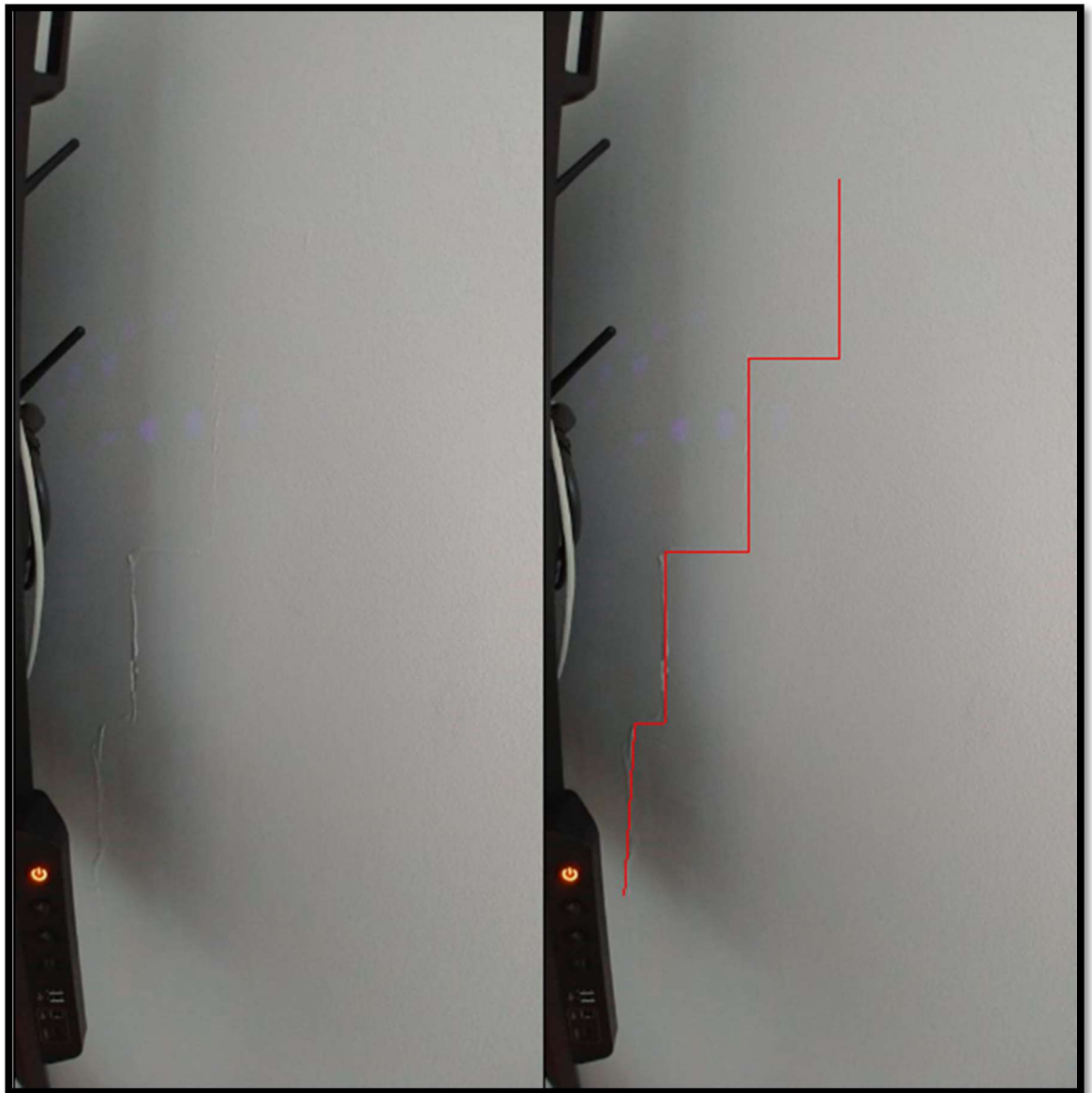
Obrázek 22: Fotografie trhliny na jižní stěně v místnosti UC. 409 a její zvýraznění, Zdroj: Autor
