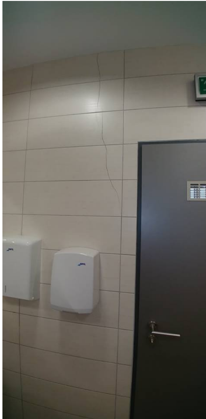
Obrázek 21: Fotografie trhliny ve stěně v místnosti US. 114, Zdroj: Autor
