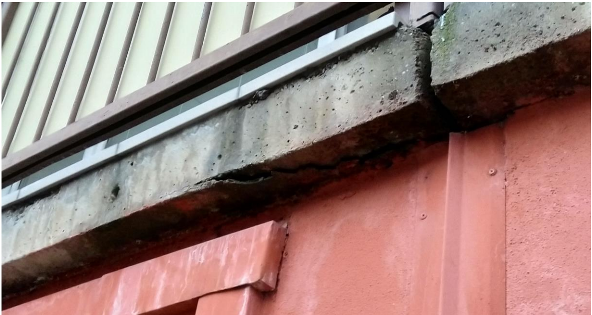
Obrázek 20 - Odpadání vrstvy betonu vlivem vlhkosti (zdroj: Vlastní)
