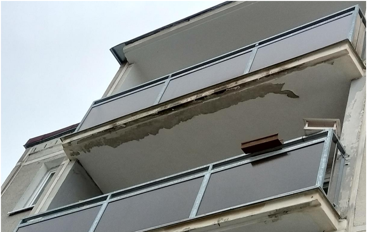
Obrázek 21 - Odpadání povrchové úpravy vlivem vlhkosti a stékající vody (zdroj: Vlastní)
