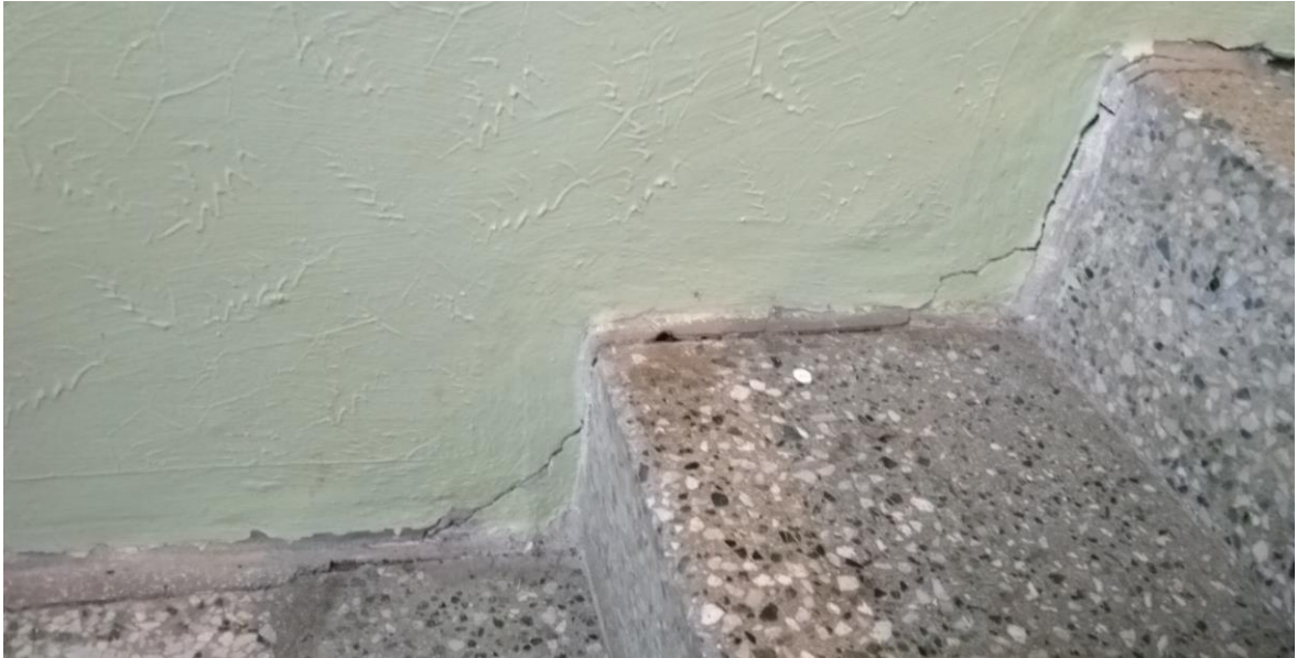
Obrázek 77 - Prasklina podél schodišťového ramene (zdroj: Vlastní)
