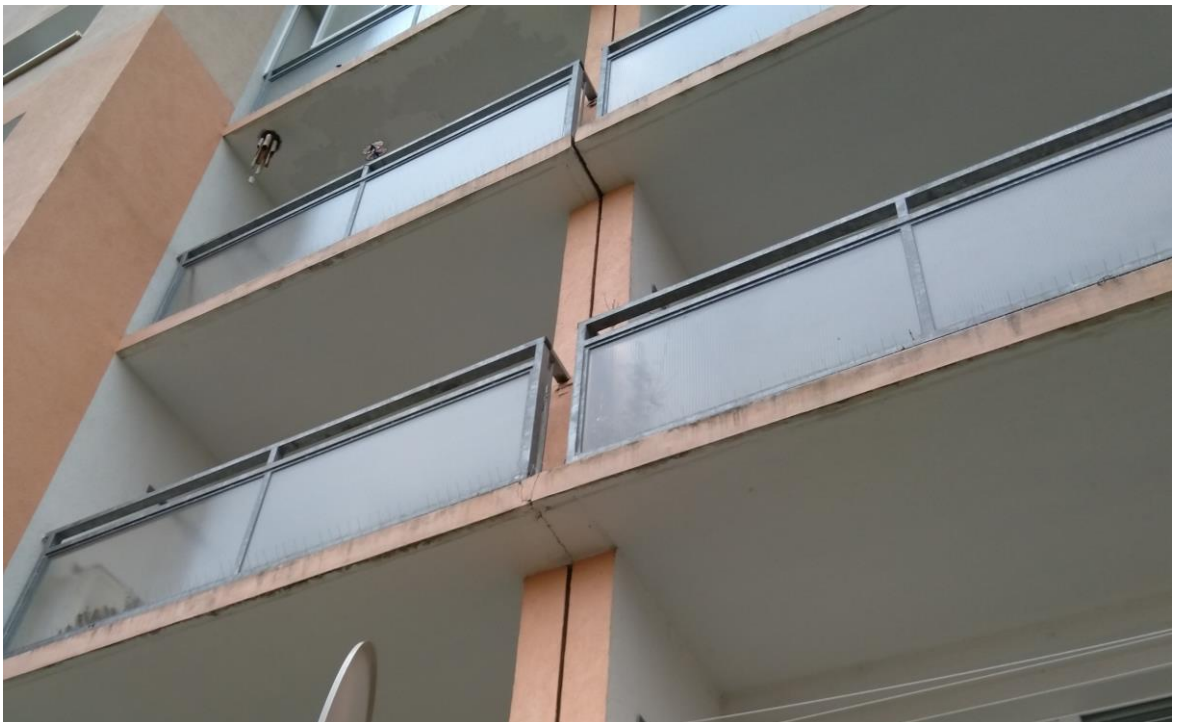
Obrázek 22 - Trhliny vzniklé nedodržením spáry pro potřeby dilatačním pohybů (zdroj: Vlastní)
