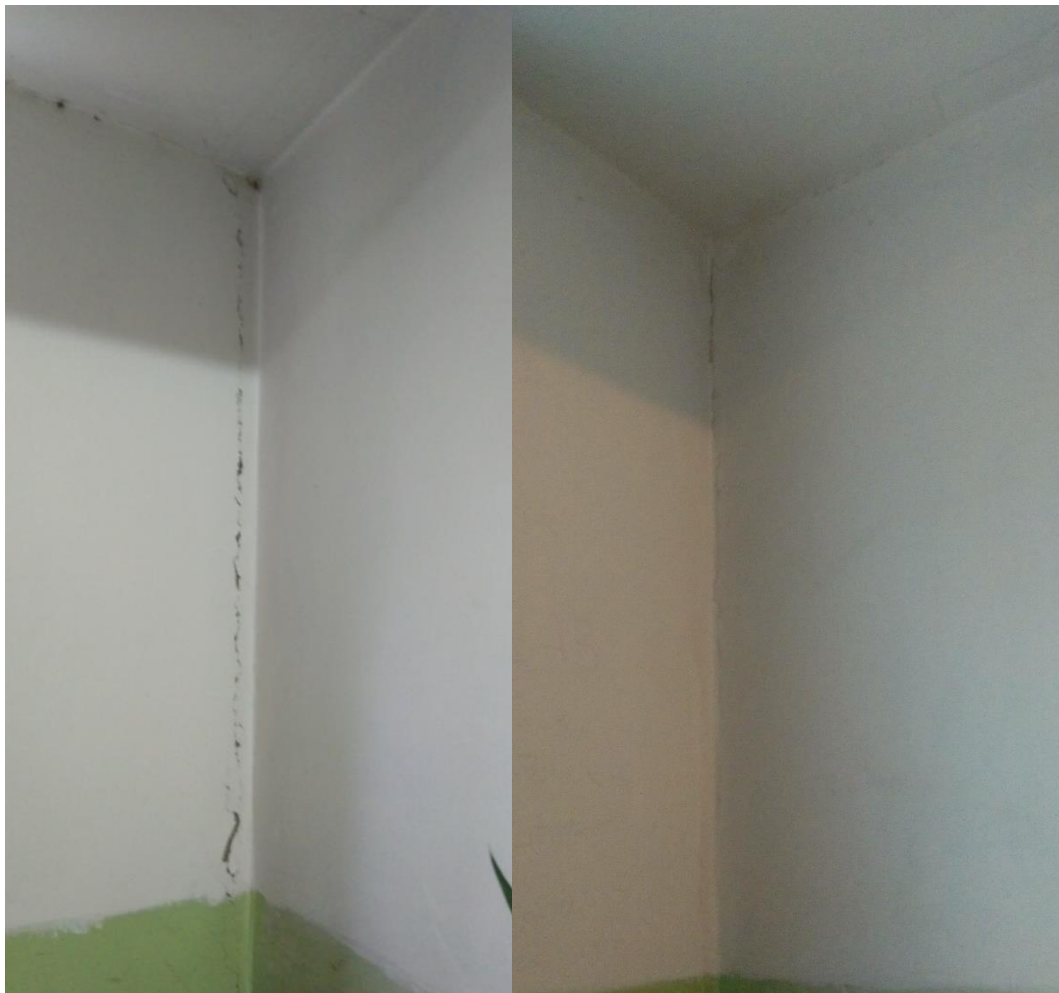
Obrázek 19 - Trhliny ve styku obvodových dílců a vnitřní nosné stěny v různých podlažích (zdroj: Vlastní)
