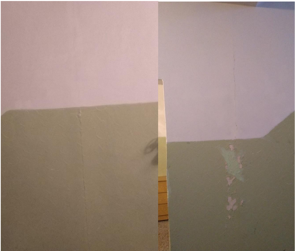
Obrázek 23 - Trhlina ve styku stěnových panelů (zdroj: Vlastní)
