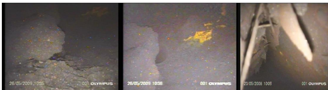
Obr. 11: Usazeniny nalezené během endoskopické kontroly prostoru kapes kolektoru na JE Temelín
