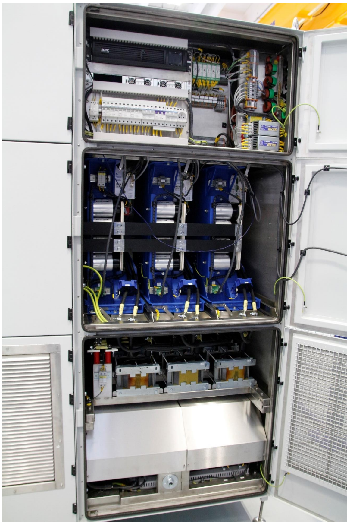
Příloha F: Pohled na otevřenou část rozvaděče Zařízení pro kompenzaci
