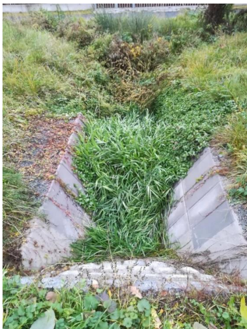
Obrázek č. 17: Betonové koryto dešťového oddělovače zanesené vegetací
