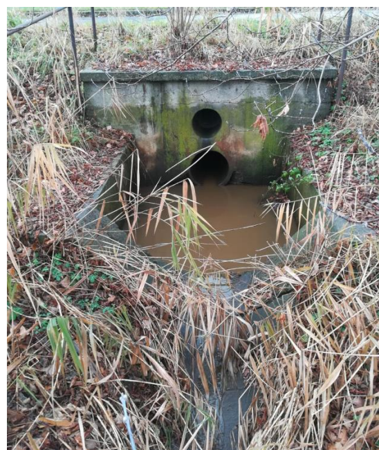
Obrázek č. 16: Zákal v přepadové nádrži dešťového oddělovače
