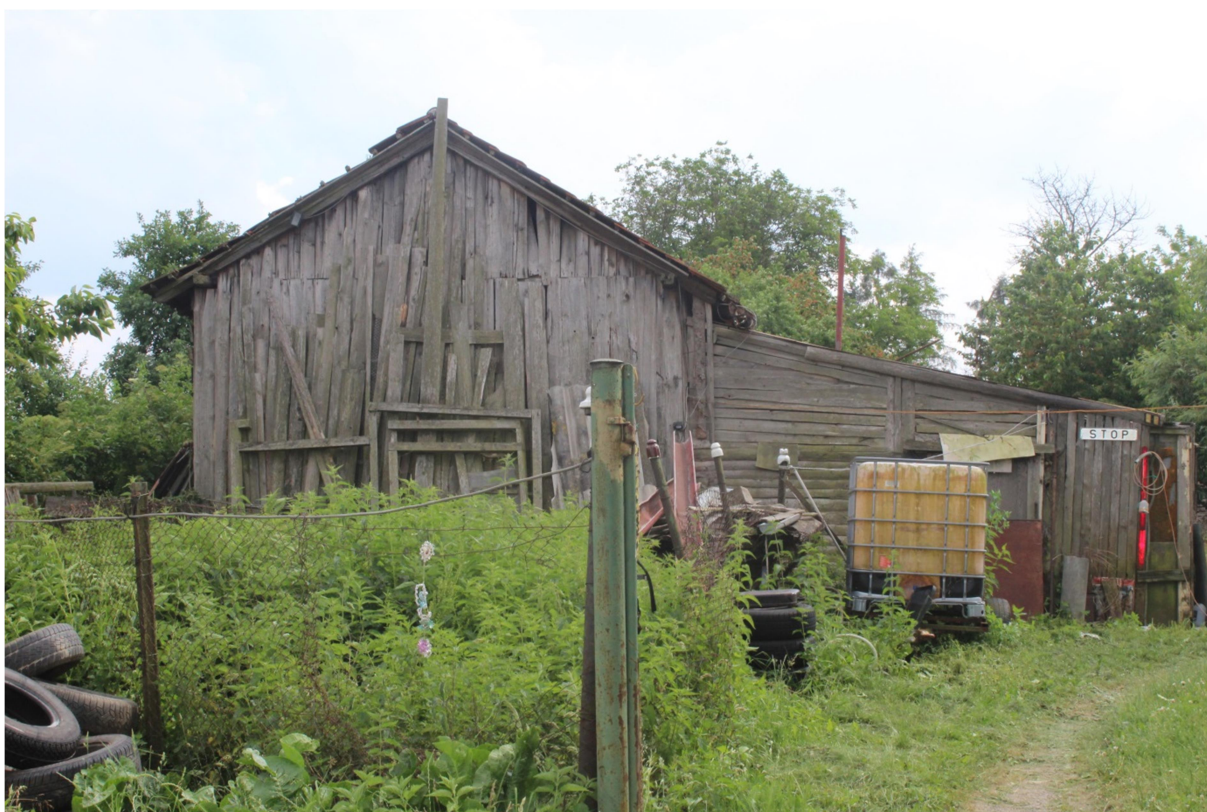
Obrázek 6 - Rozpadlé kolny určené k demolici
