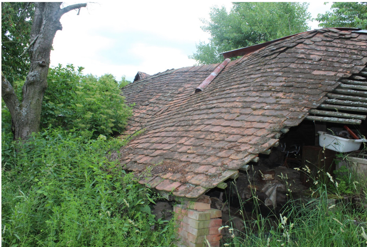
Obrázek 5 - Rozpadlé kolny určené k demolici
