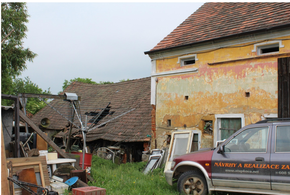
Obrázek 4 - Rozpadlé objekty určené k demolici
