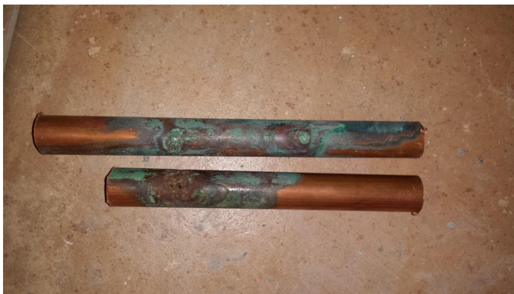
Obrázek 4-1 Koroze měděných trubek ústředního topení v podlaze [27]
