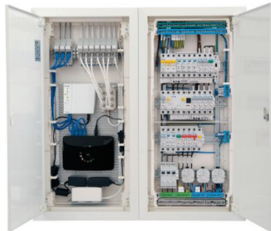
Obr.3.1 Nástěnný domovní rozváděč (DR) [5]
