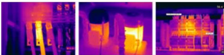
Obrázek 23 Poškozené elektrosoučástky detekované pomocí termokamery [4.3.10]
