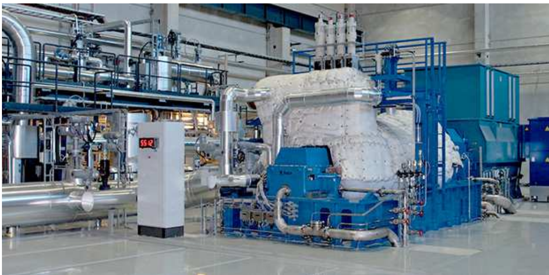
Obr. č. 2 Strojovna s parní turbínou 38
