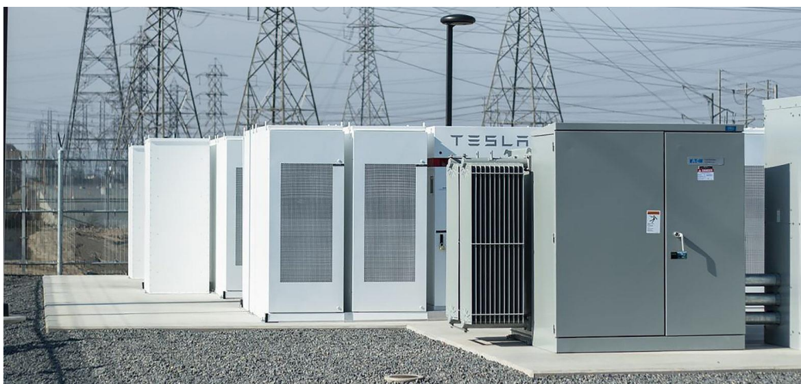
Obr. 3.10 - Síťové uložení Tesla Powerpack, instalované na poloostrově Nova Scotia pro ukládání větrné energie, kapacita každé jednotky je 210 kWh, váha 1,6 tuny (zdroj: Nova Scotia Power)
