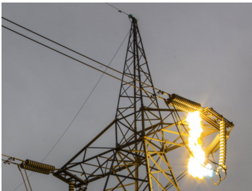
Obr. 3: Hořící elektrický oblouk, [37]
