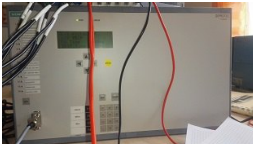
Obr. 5.1: Testovaná ochrana Siprotec 7UM62
